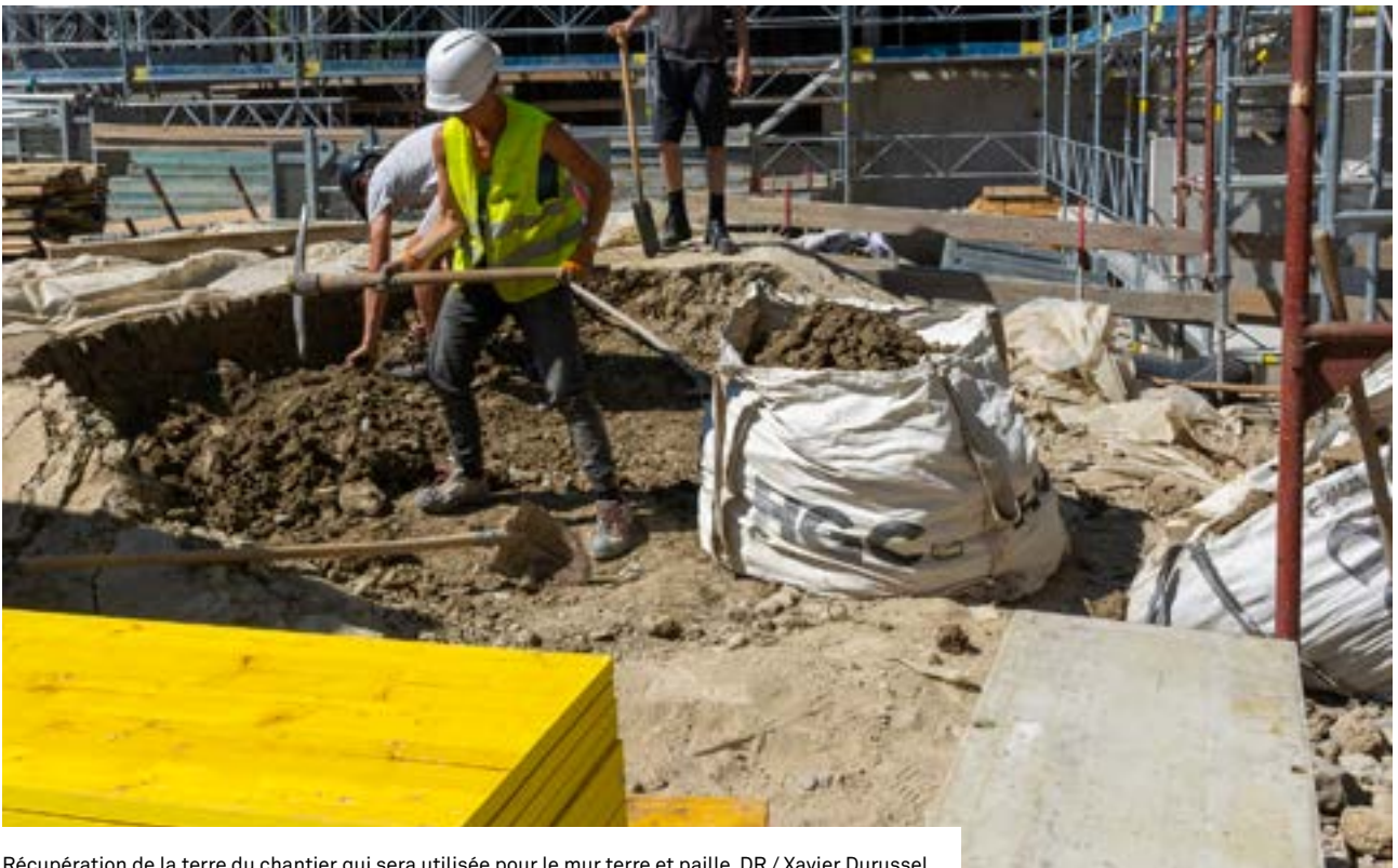
Récupération de la terre du chantier qui sera utilisée pour le mur terre et paille. DR / Xavier Durussel
